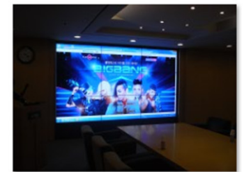
(동경티앤씨) 멀티비전 설치사례 (14)_CJ.JPG
