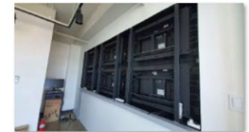
(동경티앤씨) 멀티비전 설치사례 (54)_제주두산.jpg
