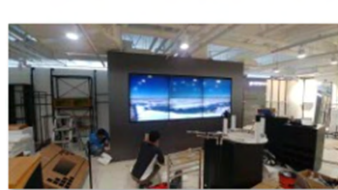
(동경티앤씨) 멀티비전 설치사례 (47)_세종출.jpg
