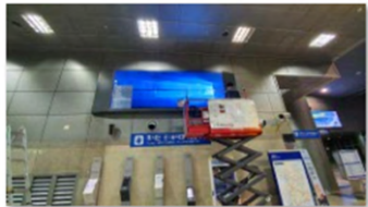
(동경티앤씨) 멀티비전 설치사례 (46)_청량리.jpg
