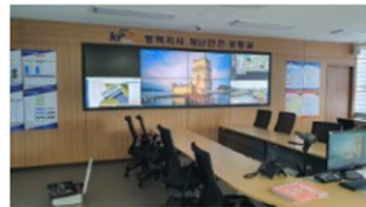
(동경티앤씨) 멀티비전 설치사례 (57)_농어촌평택.jpg
