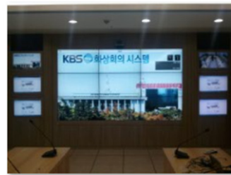
(동경티앤씨) 멀티비전 설치사례 (8)_KBS.jpg
