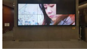
(동경티앤씨) 멀티비전 설치사례 (52)_국세청.jpg
